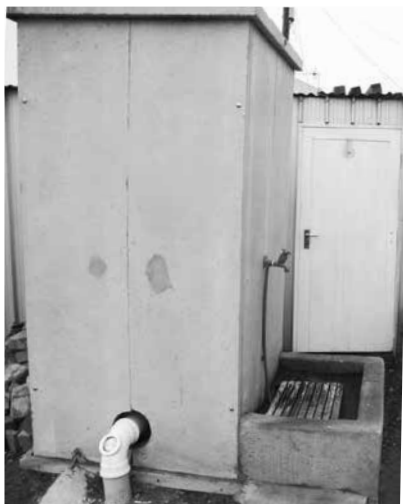
Unità centrale per la fornitura di servizi / service core unit, Kuku Town Courtesy SA SDI Alliance
