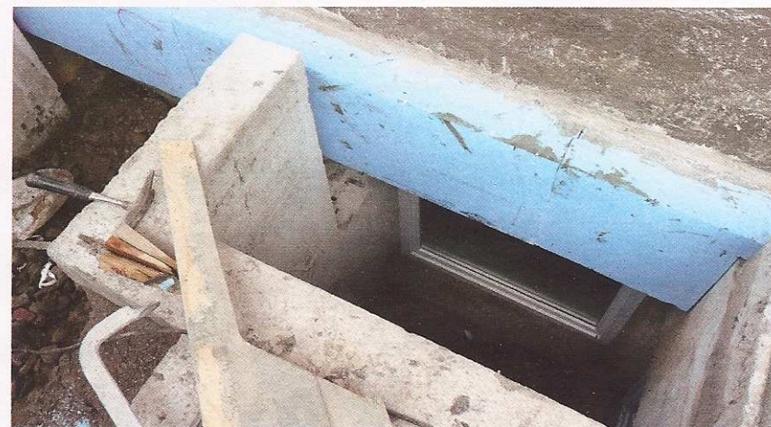
Taglio termico sulla bocca di lupo
